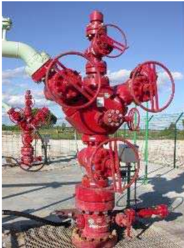
Tête de puits avec les deux forages (doublet) dans leur enclos
