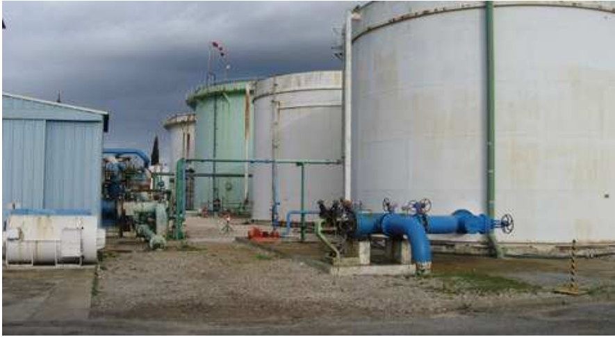
Arrivée Eau de BRL (en bleu), bacs tampons (en blanc) et bac à saumure (en vert)
